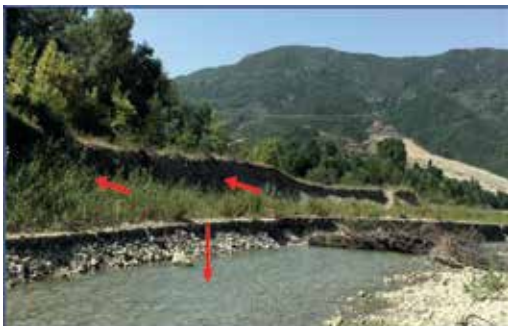
Foto 3. Erozion anësor në Dobresh. lumit, Pezë Helmës.
